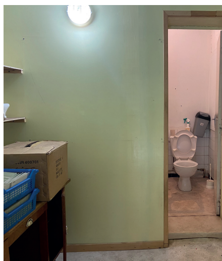
AVANT : locaux techniques vétustes, hors normes d'hygiène et sécurité (1 bloc toilettes pour 2 agents homme-femme, donnant directement dans le bureau)
